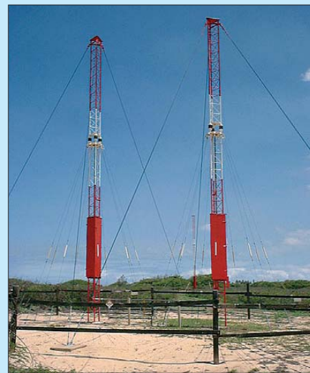
Phasengekoppelte Vertikalantennen für 15 MHz bei der Station WWVH auf der Kauai-Insel, Hawaii, USA Fotos: OK1DUB (1), NIST (1)
